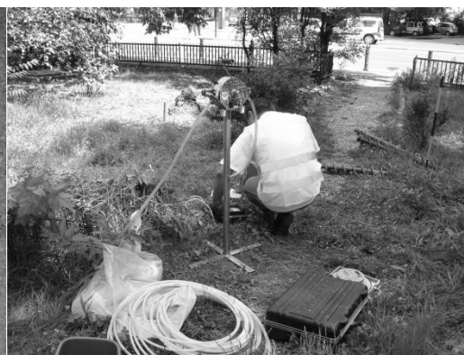
Fig.9 Purjare puț monitorizare
